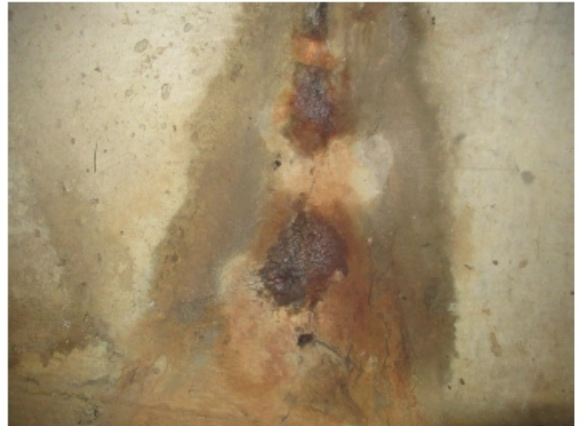
Rustudfældninger i samling mellem rør
