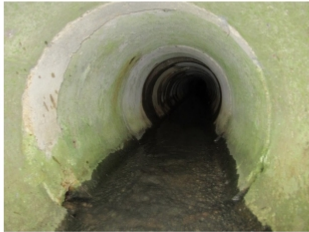
Set fra syd mod nord. Forskudte elementer samt revner
