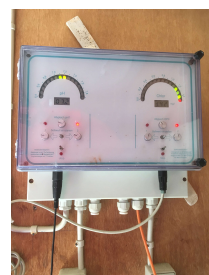
Anlæg der måler og styrer tilsætning af klor/syre
